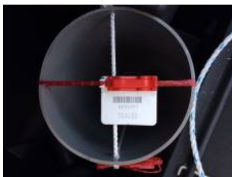
Foto 2: Detalle interno de la boya obturador.
