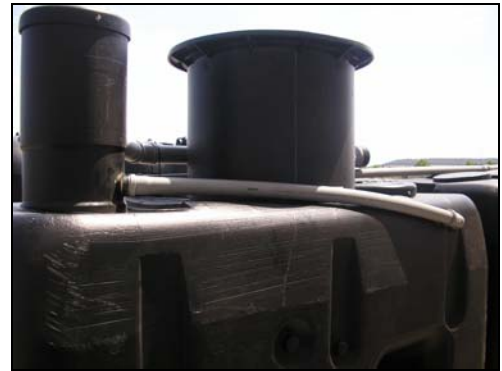
Recirculación de lodos a biológico.
