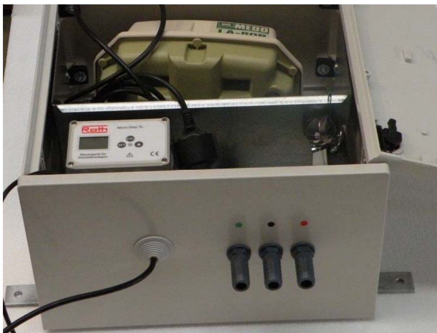
Fig: Detalle parte inferior de cuadro control eléctrico
