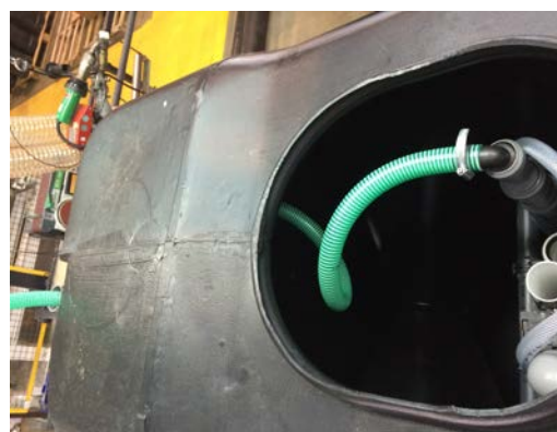
Manguera corrugada en entronque del air-lift. Sale del depósito por el lateral hacia el depósito contiguo.
