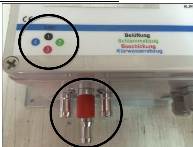
Imagen 6: entronques de conexión de cuadro eléctrico
