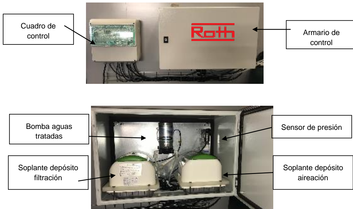
Fotografía 7: vista consola técnica, armario y foto interior del cuadro.
