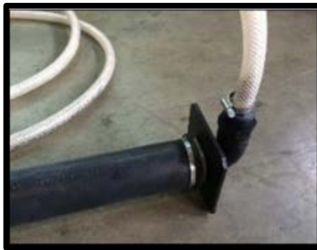
Fotografía 5: conexión manguera a difusor.
