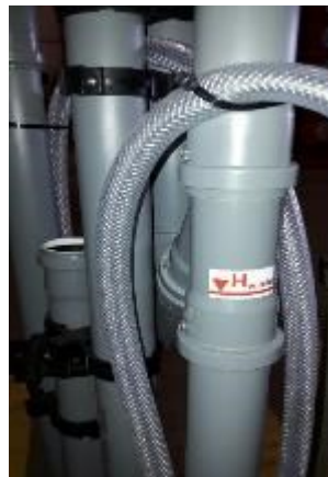
Imagen 11 Indicación de la altura H min en el depósito digestor
